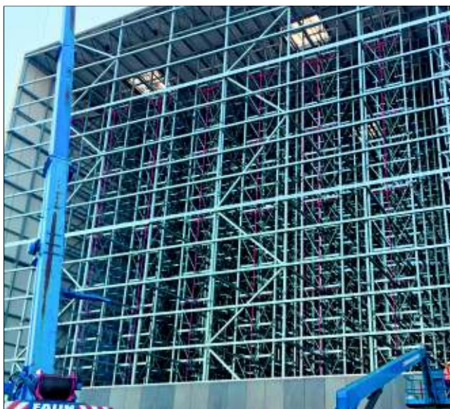
W pełni zautomatyzowany magazyn wysokiego składowania zbudowany przez firmę SKALSKI. Obiekt ma 35 metrów wysokości
